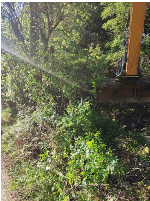
Φωτογραφία 1. Όρια οικισμού με τον αγροτικό χωματόδρομο, κατά τη διαδικασία καθαρισμού του ρέματος.
