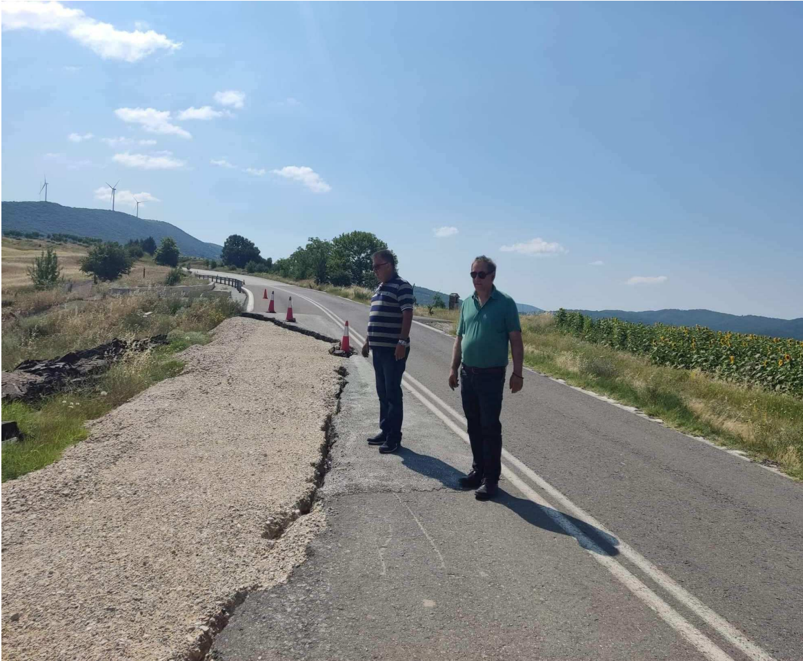
7. Δήμος Σερβίων, Αυτοψία μαζί με τον Αντιπεριφερειάρχη στο δρόμο για Τριγωνικό στο Δήμο Εορδαίας για Κατολισθήσεις Ιούνιος 2022
