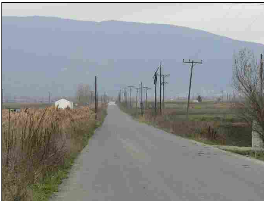
Φωτ. 2.1: Άποψη οδού όπου φαίνονται οι επιπτώσεις της καθίζησης (γερμένοι στύλοι Δ.Ε.Η.) (Ημ. λήψης 2/12/2007).
