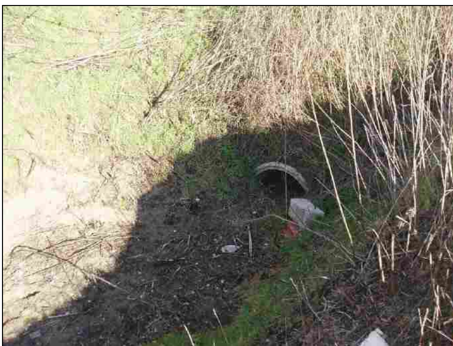
Φωτ. 3.7. Άποψη συσσώρευσης φερτών υλικών στην είσοδο αγωγού (Ημ. λήψης 3/9/2009).
